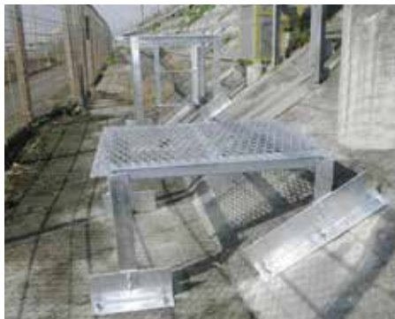
配電盤点検足場台
