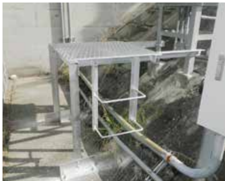
配電盤点検台
