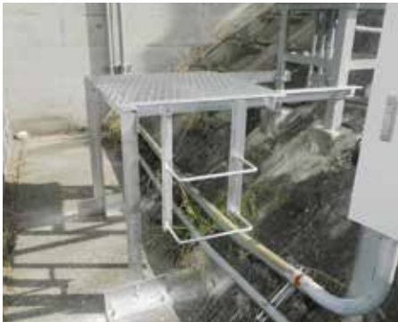
配電盤点検台
