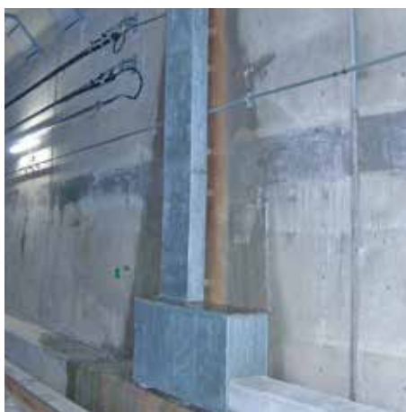
ケーブルダクト
